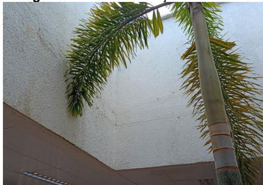
Figura 24 – Fissuras no jardim de inverno
