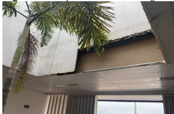
Figura 25 – Colapso do acabamento de gesso.
